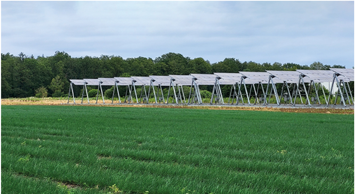
Agriphotovoltaikanlage. Foto: Lara Diekmann
