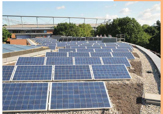
Sonnenkollektoren auf dem Dach des Sportinternats
